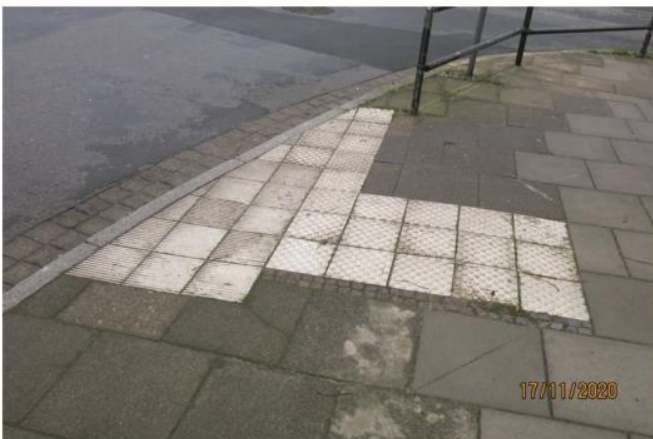
Taktiler Leitsystem: Nur punktuell vorhanden und nicht nach den aktuellen Planungsstandards
