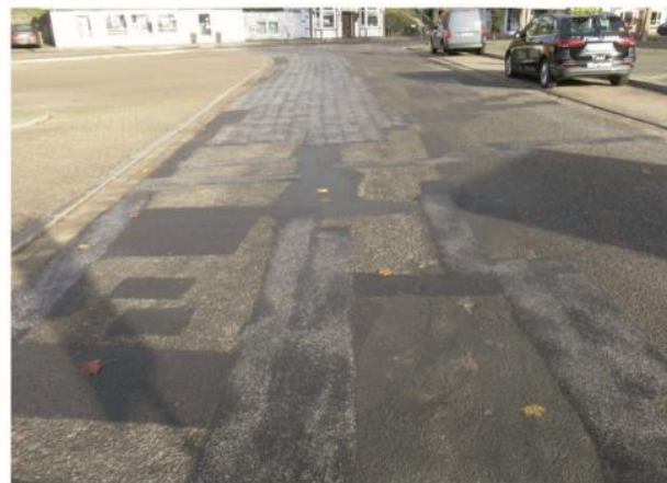
Sanierungsbedarf: Defekte Fahrbahnflächen bei der Straße am ZOB und der Bahnhofstraße
