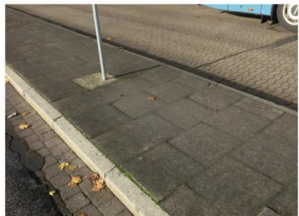
Bushaltestellen (ZOB): Fehlende Barrierefreiheit, keine regelkonformen Abmessungen und Zugänglichkeiten
