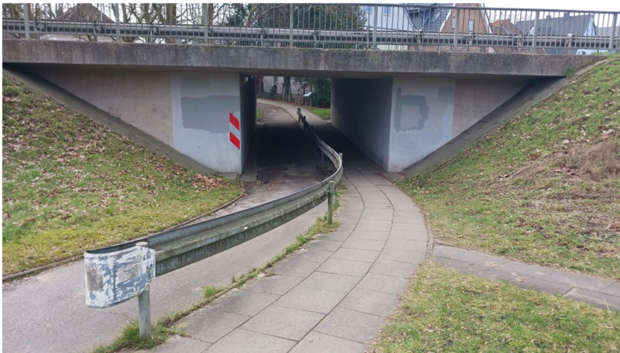
Einfahrt II in Eutiner Straße mittels engen Tunnels unter B76 mit gefährlicher Autoleitplanke
